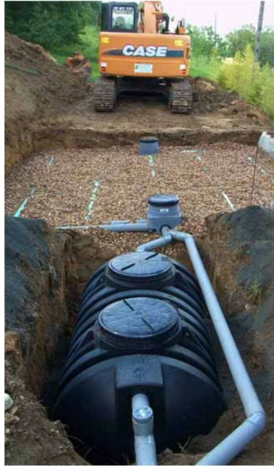
Photo : Fosse toutes eaux et filtre à sable
