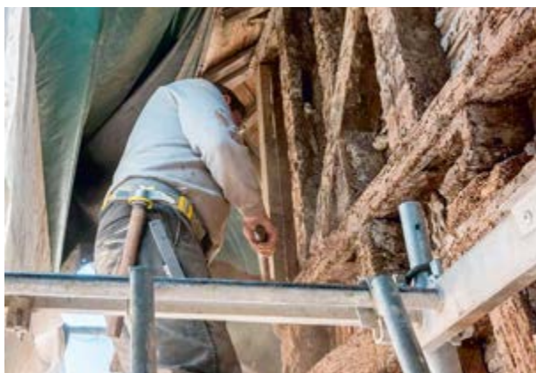
Travaux sur la façade en pan de bois de la maison, 8 rue Bienheureux Pierre René Rogue, 17 e siècle. © Région Bretagne.
